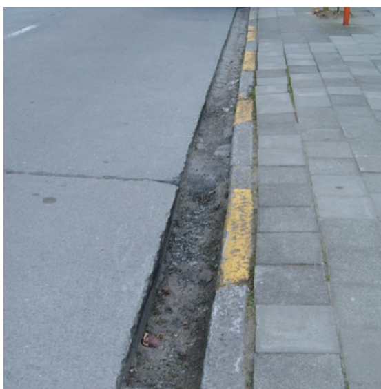
Filet d'eau dangereux pour le cycliste qui ferait un écart
